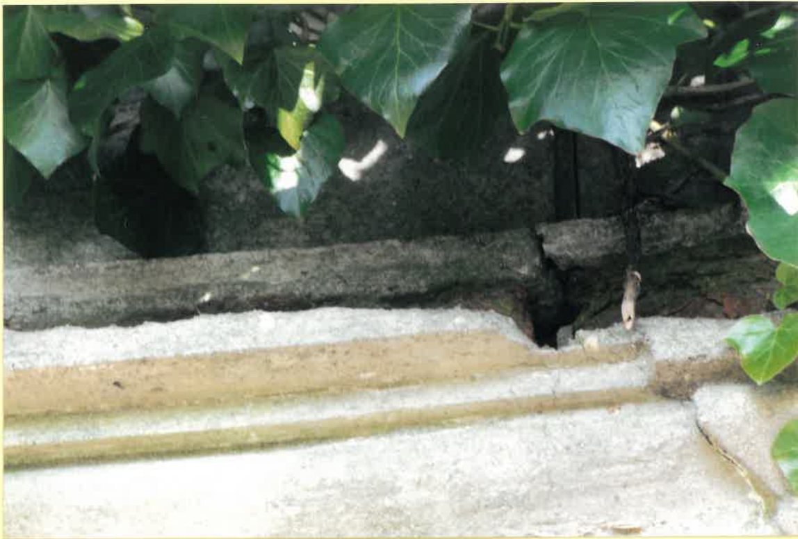
Fot.4. Fragment gzymsu wieńczącego pomnika z widocznym rozwarstwieniem struktur murowych i ubytkiem profilu.
