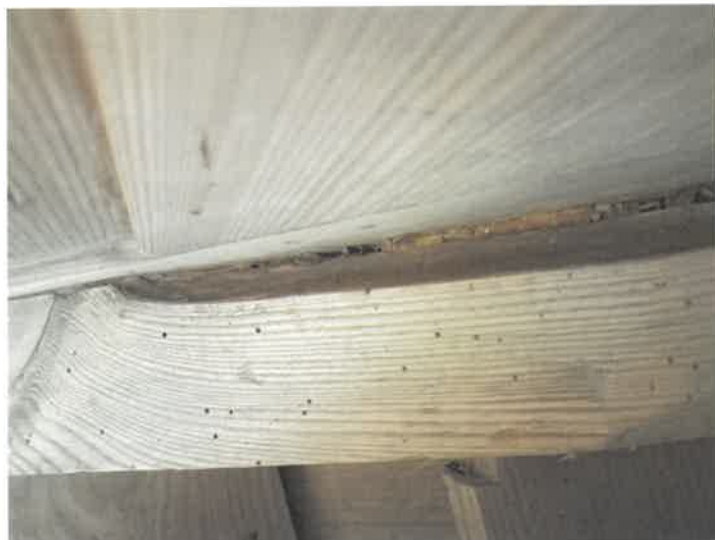
Fot. 2: Uszkodzenia drewna powstałe na skutek działalności owadów. Fot. Aleksandra Krajewska-Łapiak.
