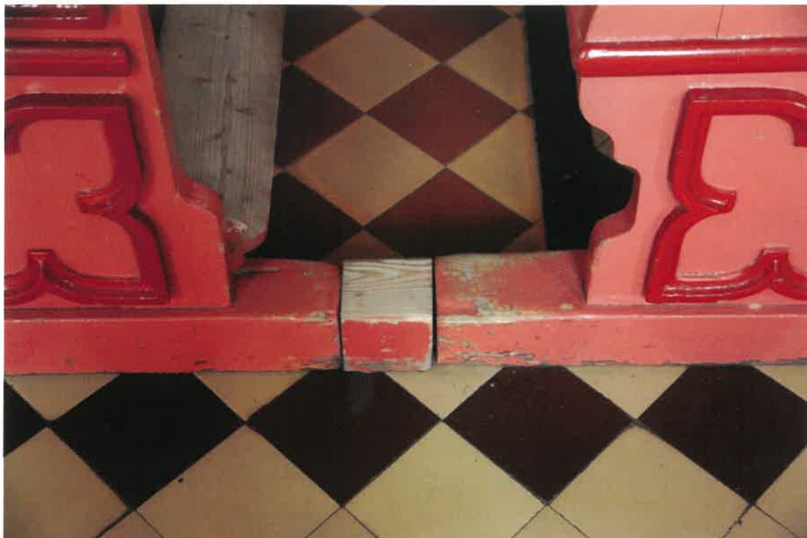
Fot. 11. Wstawki pomiędzy płozami ławek, które zostały skrócone, ponieważ końcówki uległy poważnemu uszkodzeniu lub destrukcji.
