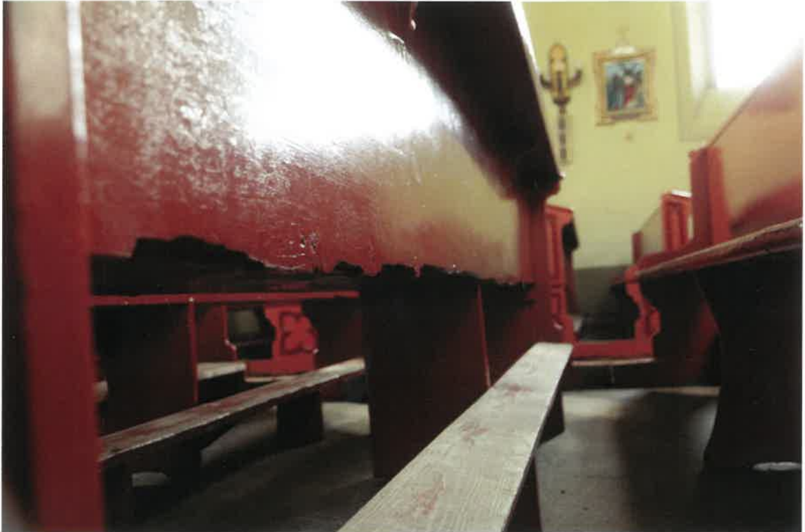
Fot. 9. Deskowe oparcie ławki z widoczną „poszarpaną” dolną krawędzią, w skutek żerowania ksylofagów.
