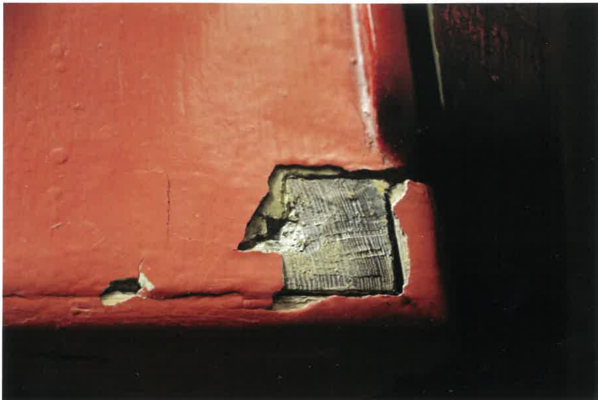
Fot. 18. Odspajanie i wykruszanie się grubych, olejnych powłok malarskich oraz rozejście się drewna w miejscu złączeń.
