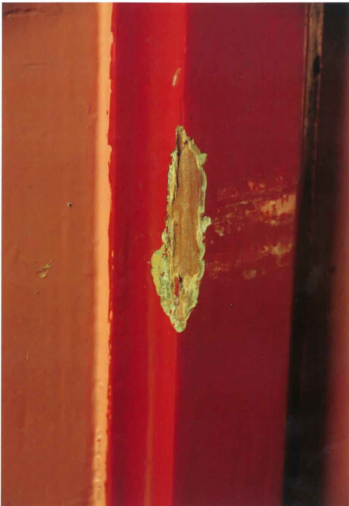
Fot. 20. Fragment listwy maswerek na przedpiersiu ławki. Uszkodzenie mechaniczne spowodowało znaczny odprysk warstw malarskich, aż do drewnianego podłoża, ukazując tym samym ilość wtórnych nawarstwień.
