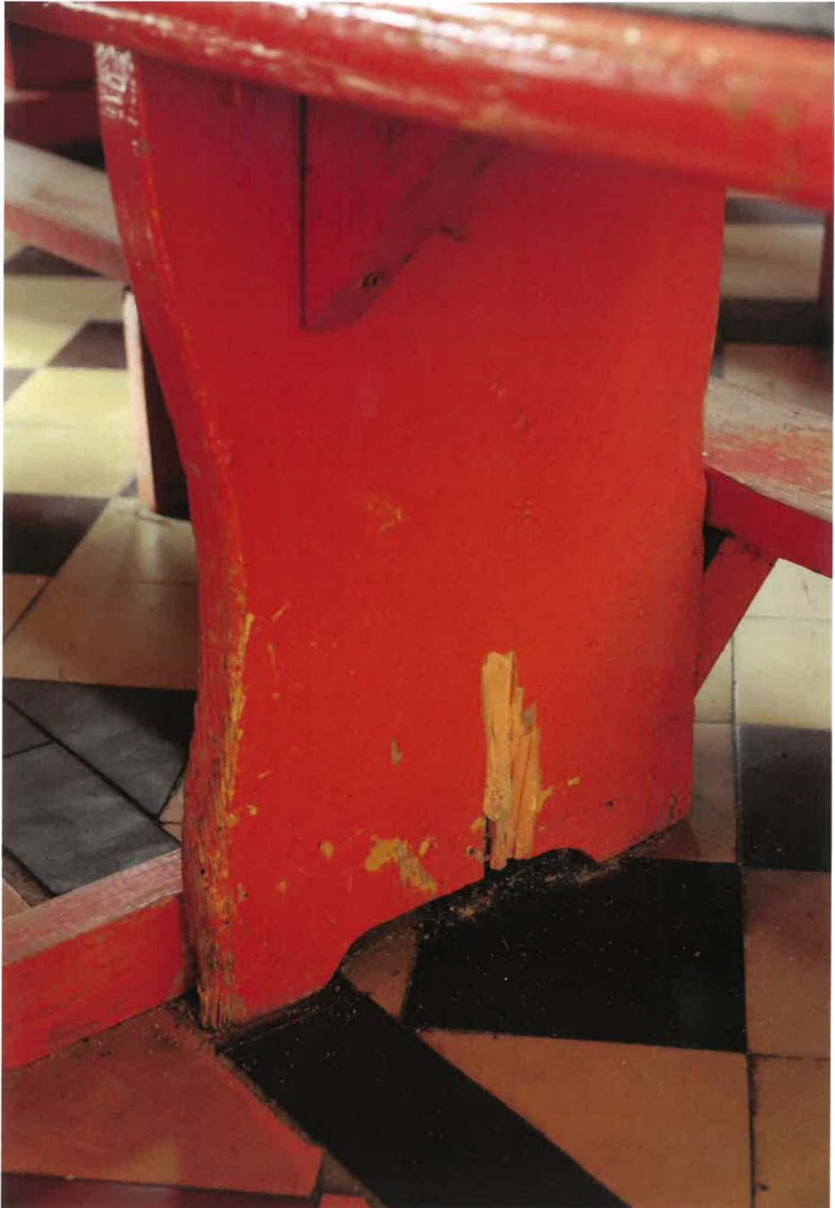
Fot. 8. Wspornik siedziska z widocznymi uszkodzeniami mechanicznymi oraz osypującym się proszkiem, świadczącym o aktywnej działalności technicznych szkodników drewna.
