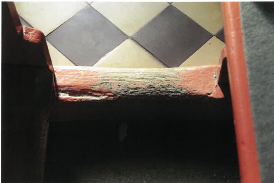
Fot. 14. Fragment płyty ze śladami zużycia i wytarcia drewna.
